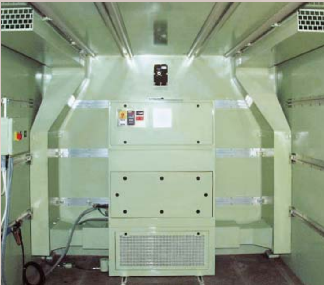
Innenansicht der Teilklimaanlage mit Luftverteilssystem
