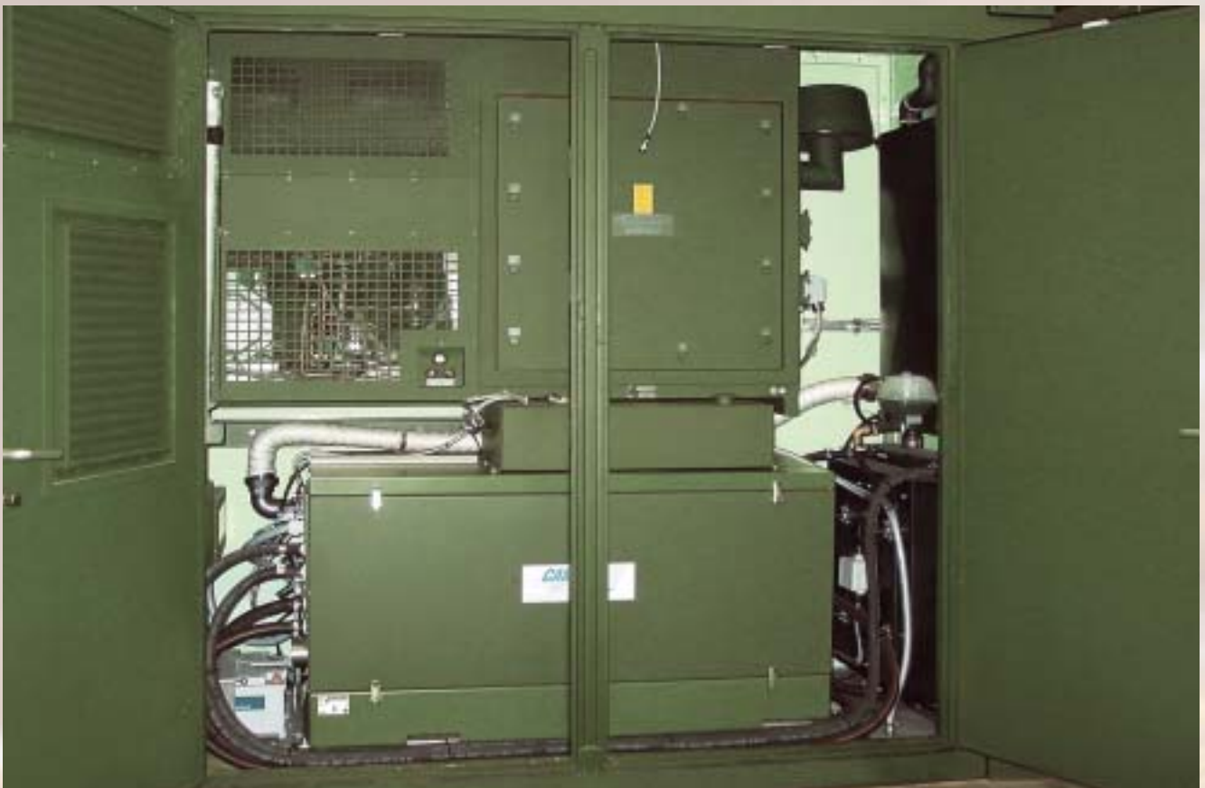
K19W-A7 in Technikraum oben eingebaut
