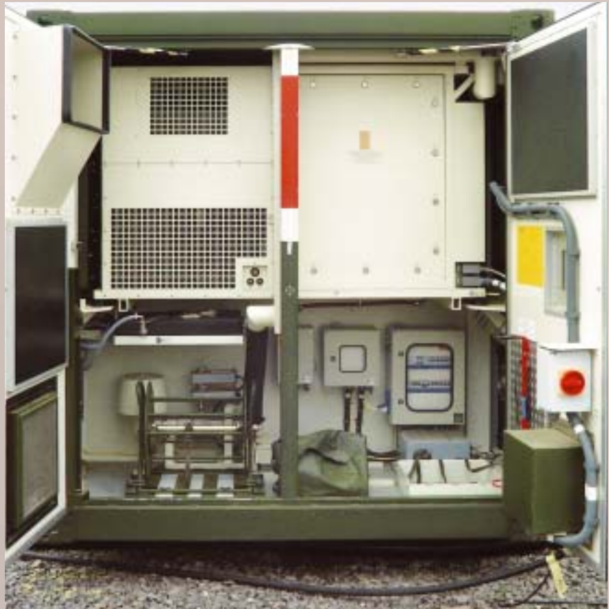
Teilklimaanlage K23W-A eingebaut im Technikraum
